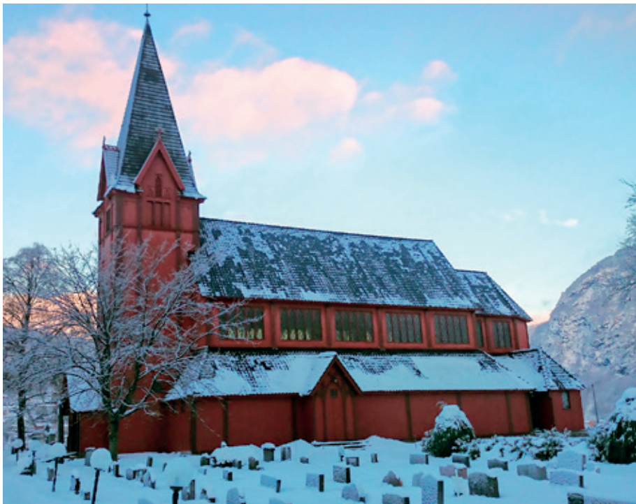
Sogndal kyrkjelege fellesråd har fått løyvd kr. 200.000,- som strakstiltak for å starte vedlikehaldsarbeid på Stedje kyrkje. Foto: Hallgeir Øgaard Westli
